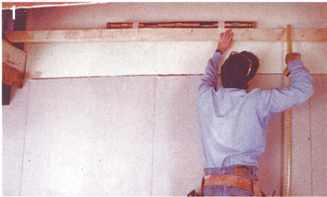
Замер высоты пролёта с помощью ровного бруса и уровня проводят непосредственно от точки опоры нижнего конца тетивы лестницы, чтобы исключить ошибку измерения, вызванную неровностью пола.
